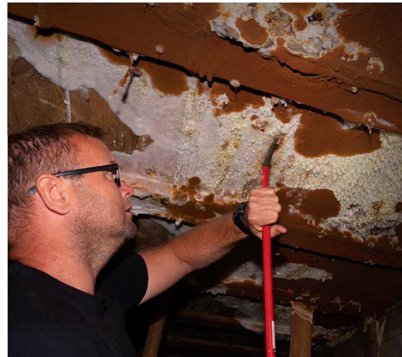
EKTE HUSSOPP: Baard Lunde-Olsen undersøker omfanget av et ekte hussopp-angrep. (Foto: Øyvind Magerøy)
