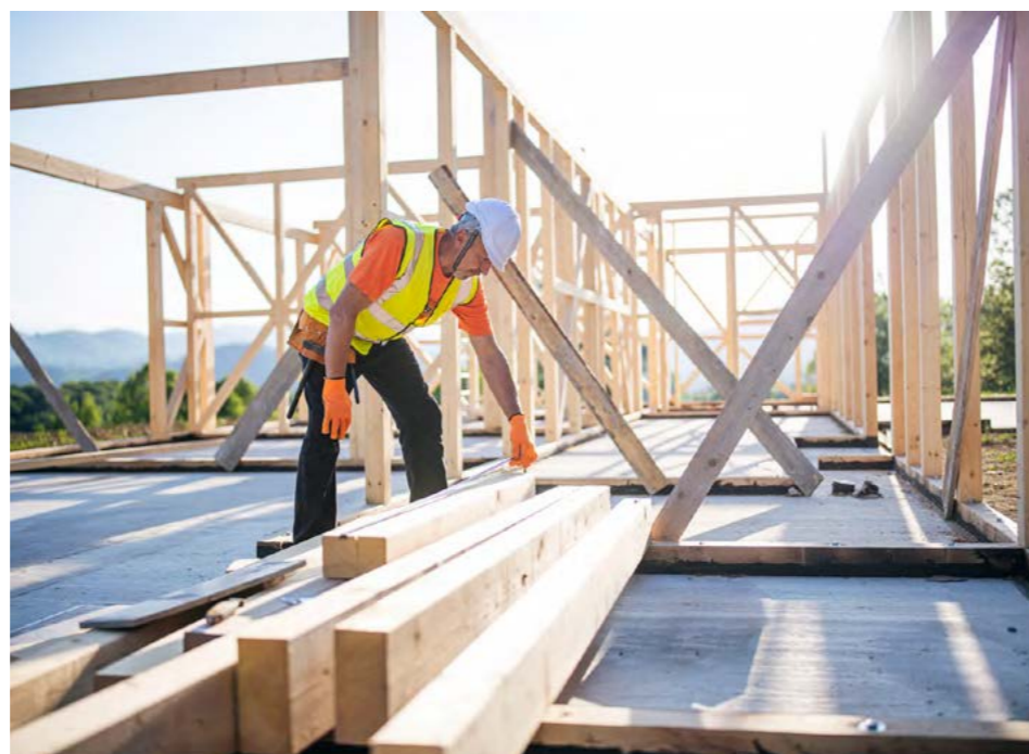
KUNNSKAPSSPREDNING: Flere tømrere fører kun opp nye bygg og møter aldri råtesopp i arbeidet sitt. Ved å få opp kunnskapen og etablere standarder for metoder, kan vi spare miljøet.
