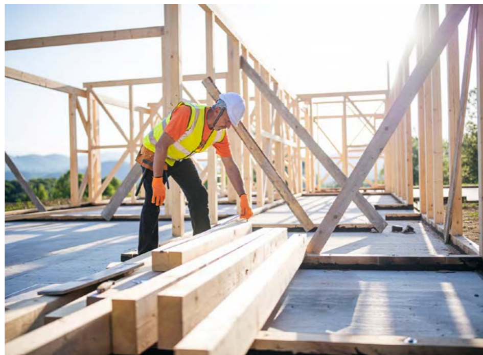
KUNNSKAPSSPREDNING: Flere tømrere fører kun opp nye bygg og møter aldri råtesopp i arbeidet sitt. Ved å få opp kunnskapen og etablere standarder for metoder, kan vi spare miljøet.
